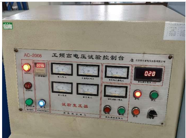
Applied voltage test for SZ-10MVA/35/10KV: L.V.~H.V.& Earth
